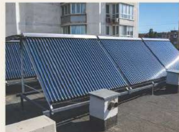
c) Hệ thống thu nhiệt mặt trời lắp đặt trên mái nhà
