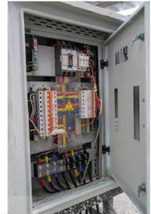
Hình 6.4. Bên trong một tủ điện phân phối
