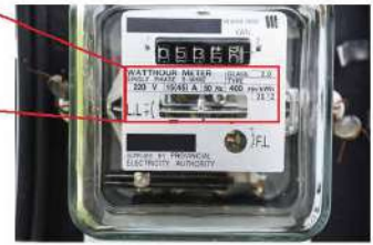
Hình 9.2. Công tơ điện 1 pha
