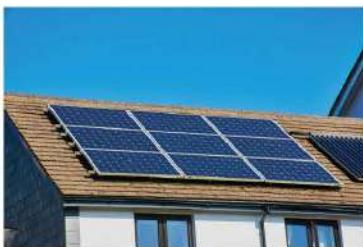
a) Hệ thống điện mặt trời áp mái
