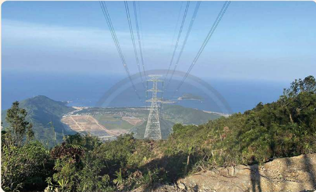
▲ Hình 10.5. Công trình đường dây điện 500 kV, đoạn qua địa phận tỉnh Quảng Bình
