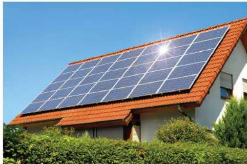
▲ Hình 12.3. Pin mặt trời gắn trên mái nhà
