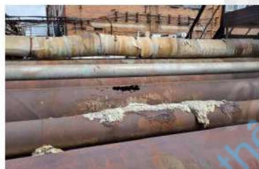
(a) Đường ống làm bằng kim loại bị gỉ
