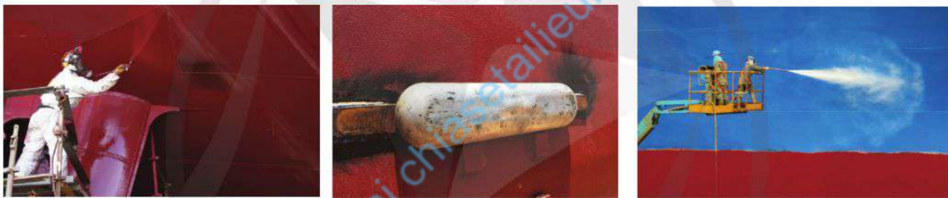
a) b) c) Hình 16.1. Các công đoạn hoàn thiện vỏ tàu bằng thép
