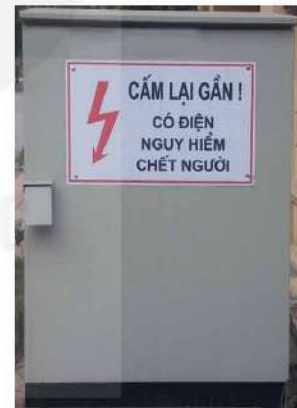
Hình 17.7. Biển cảnh báo an toàn điện
